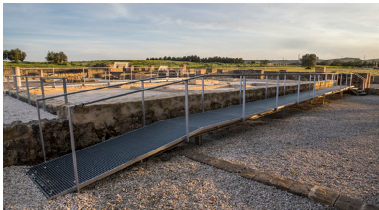
Figura 5.13. Barandillas de seguridad y de tránsito instaladas en la Casa del Planetario
