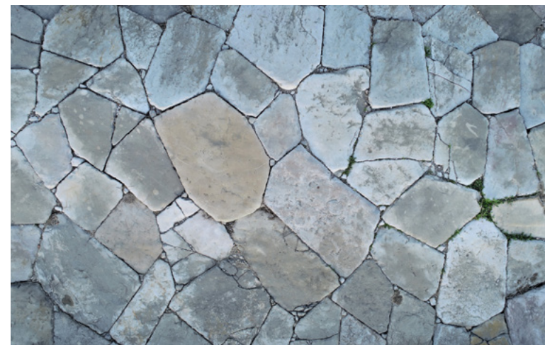
Figura II.6. Detalle de las losas de piedra de Tarifa y del aparejo del pavimento de una calle de Itálica
